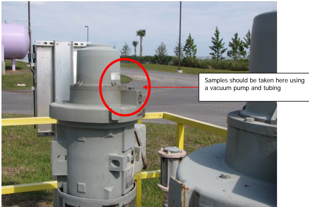
Effluent Reuse Pump
